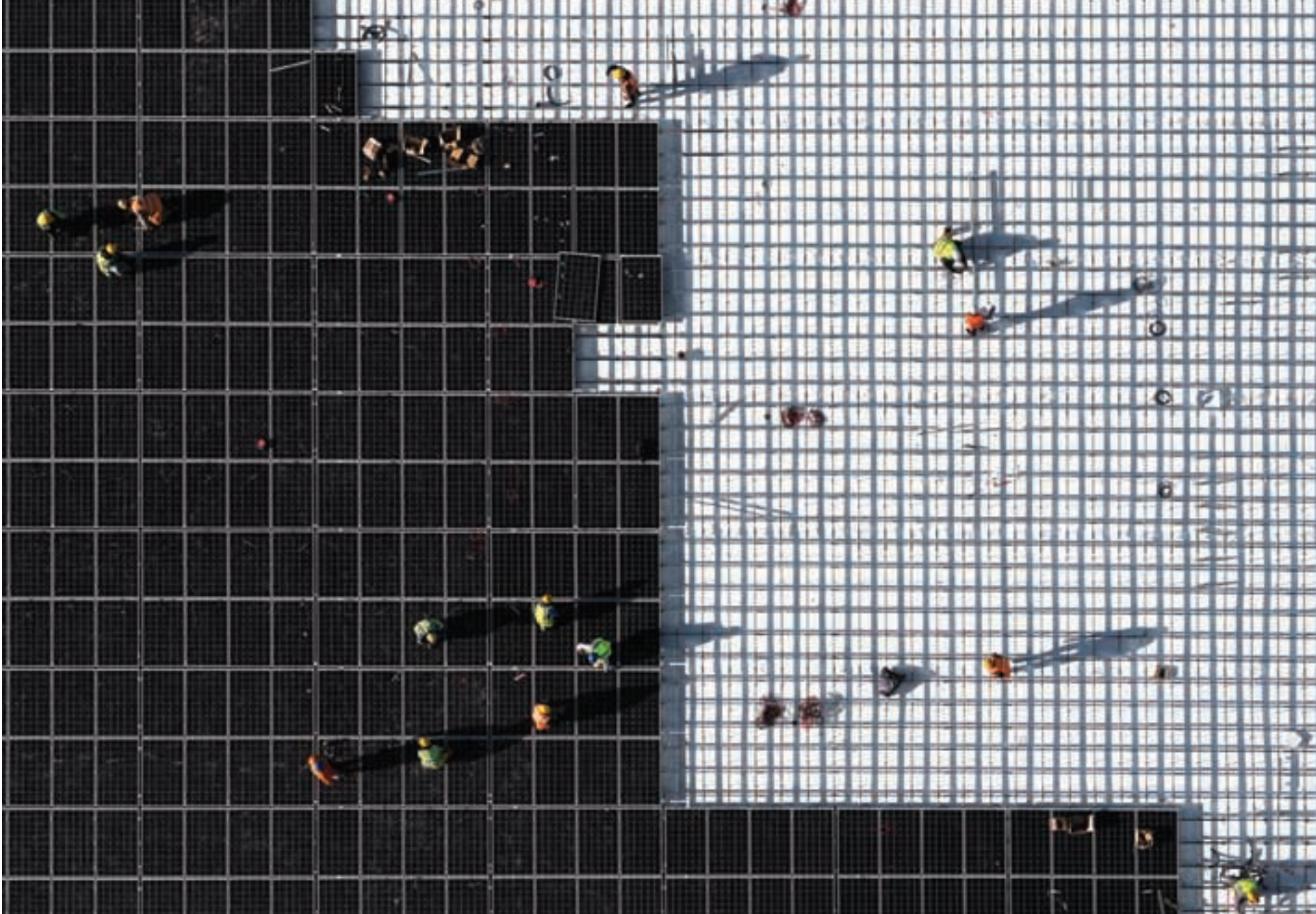
Στέγαστρο, μεταλλικό πλέγμα υποστήρι- ξης φωτο- βολταϊκών πάνελ
