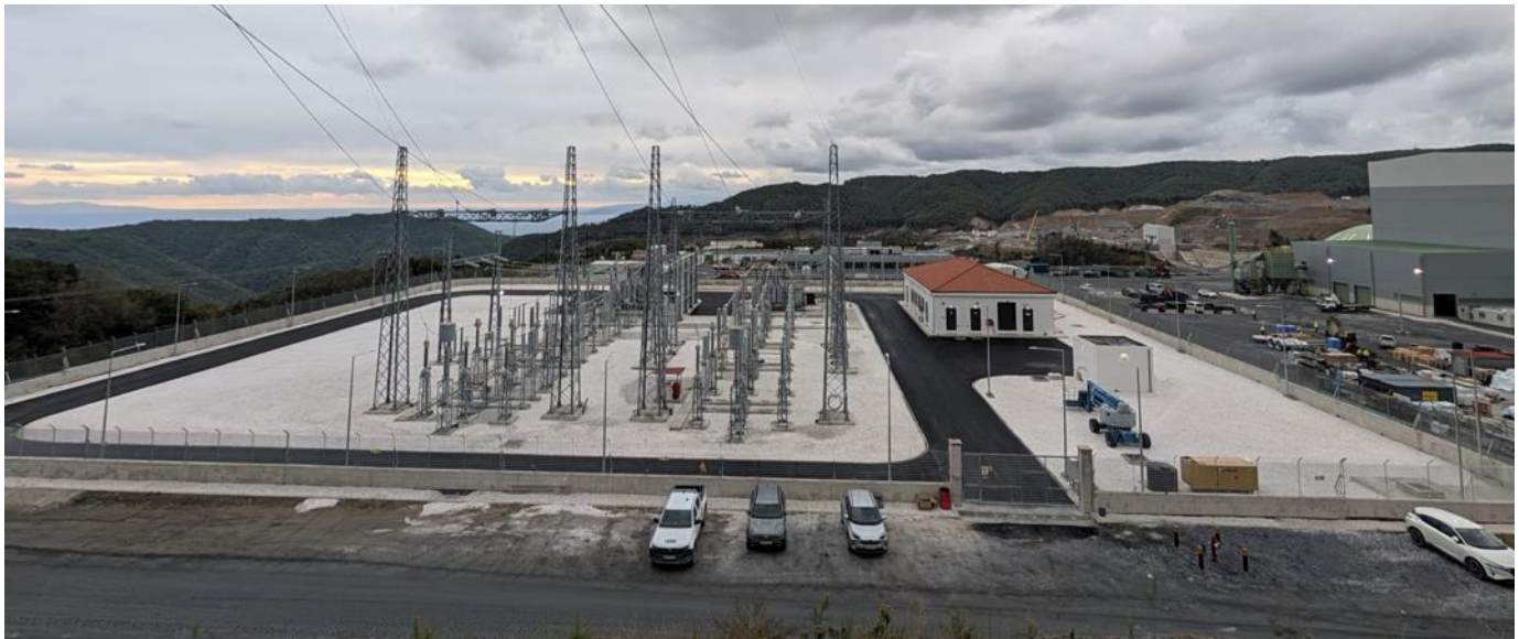
Υποσταθμός μονάδας επεξεργασίας
